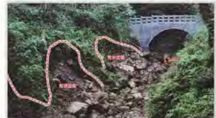
▲整治前溪床兩岸崩塌，嚴重影響鄰近檜木立地，將造成傾倒危險
